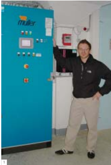
Bild 1: David Köchli, Leiter SPS-Abteilung bei der Müller AG, neben der Steuerung der vollautomatischen Pelletheizung.
